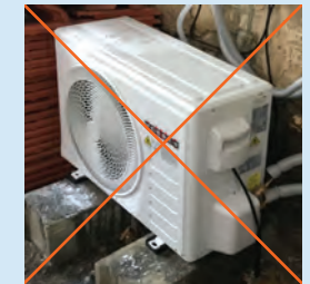
pose non conforme
